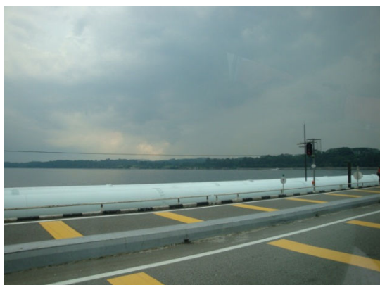
コースウエイ橋の横に架設された給水パイプ
